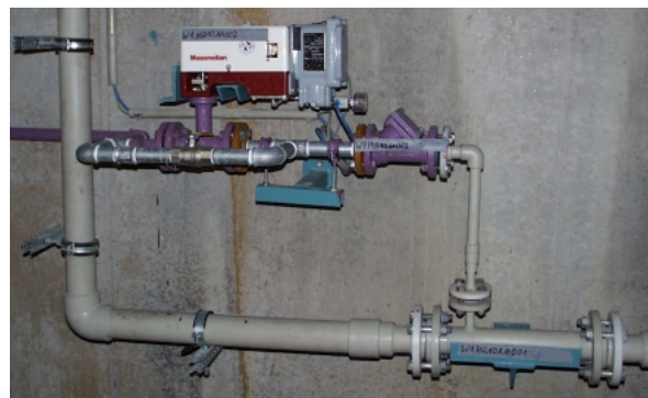
Abb. 6 Neue, verbesserte Anlage mit gleicher Wirkung: Fluitec Mischer und Natronlauge dosiersystem
