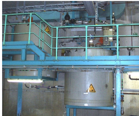
Abb. 5 Anlage mit Auffang- und Neutralisationsbehälter
