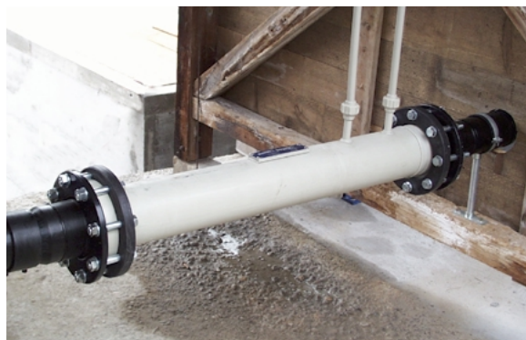
Abb. 2 Fluitec Neutralisationsmischer mit Säure- und Laugendosierstelle
