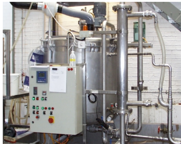
Abb. 5 Neutralisationsanlage im Umlauf
