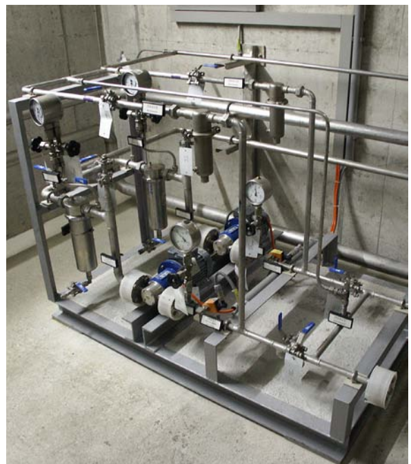
Abb. 2 Redundante Pumpenstation für Additive
